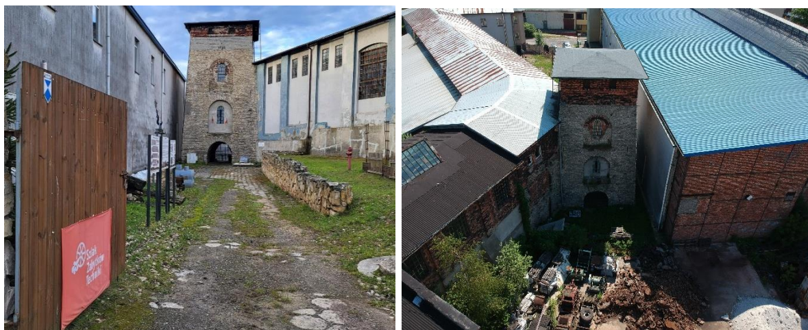
Fotografia 9 - Wieża Gichtowa w Porębie - zabytek w złym stanie technicznym (stan na 2025 r.) Źródło: Archiwum własne.
